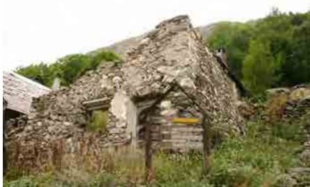
Bâti en ruines
