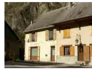
A gauche, les ouvertures ont été modifiées, les linteaux bois sont un pastiche, les volets ne sont pas peints et l'enduit est un crépi façon "rustique" non traditionnel.
