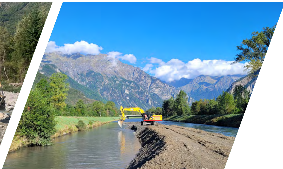
Bourg d'Oisans - travaux prioritaires sur les digues de la Romanche
